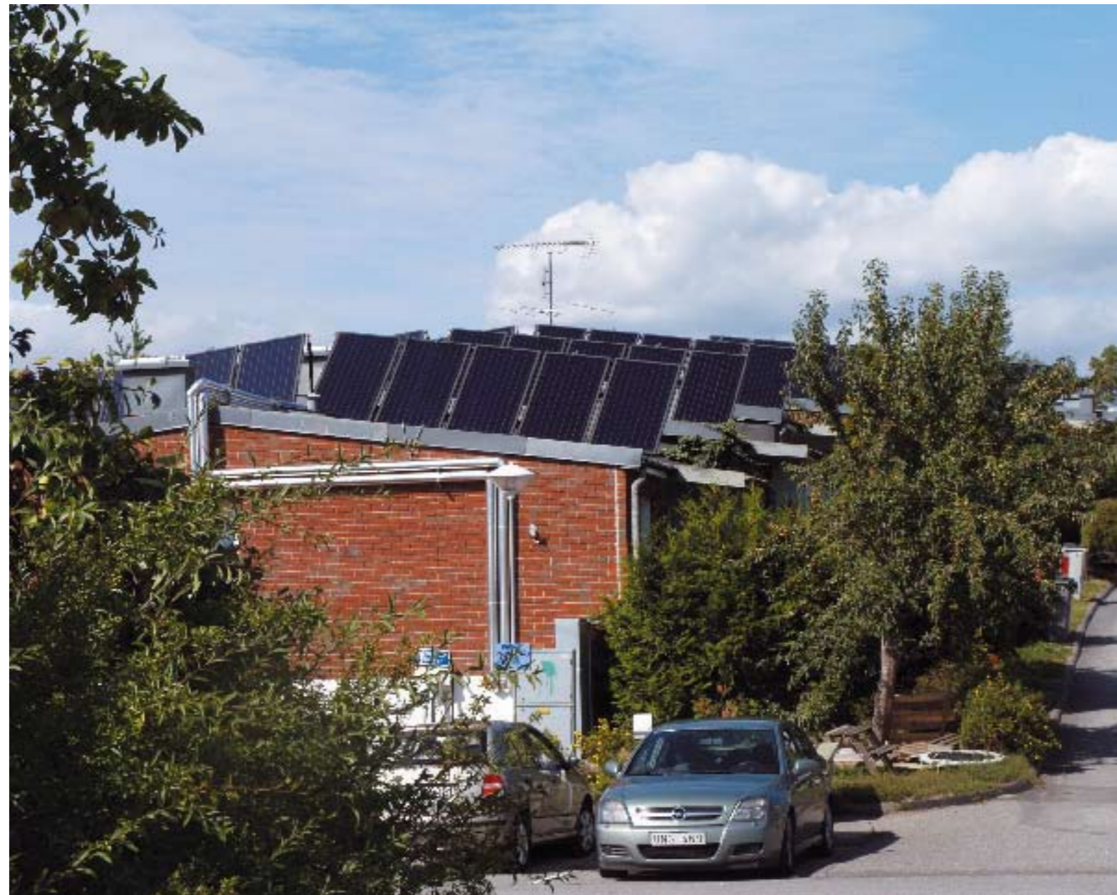
60 solfångare har satts upp på radhusens tak i direkt söderläge med 45 graders vinkel mot solen. Solvärmens ger dels tappvarmvatten, dels extra värme till grundvattnet nere i berget när
