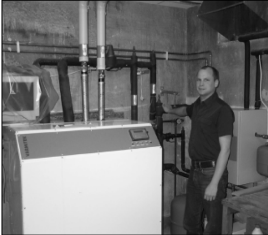
Värmecentralen i pannrummet visar att såväl bergvärme som solfångare fungerar väl. Kristian Öhlander i Brf Norrgärdet är nöjd med systemet som nu varit igång en tid. - Vi har aldrig tidigare varit så nöjda med tekniska leverantörer. De har skött allt perfekt, säger han.
