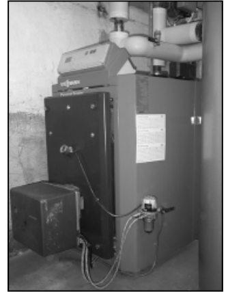
Oljepannan som står kvar, används bara för spetsvärme under riktigt kalla dagar vintertid.
